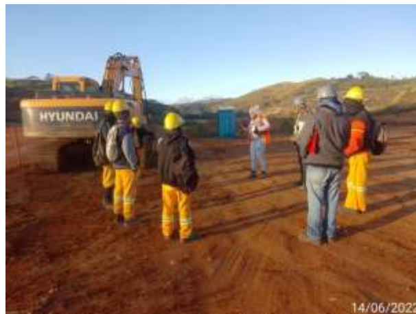
Foto 4 – Treinamento sobre Uso Sustentável, realizado com equipe na frente de serviço da fundação. Data: (14/06/2022).
